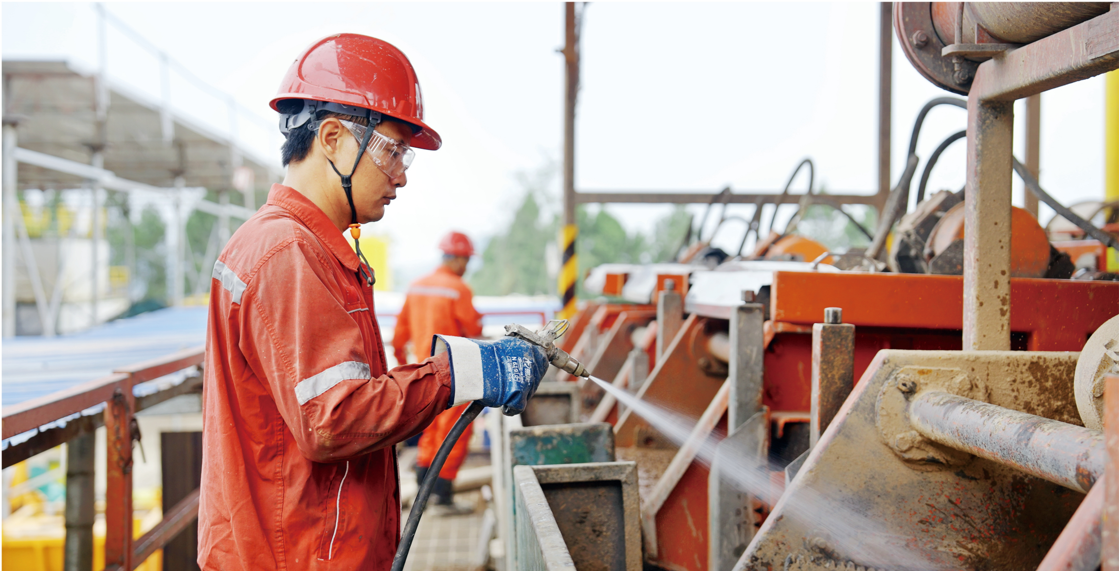
丰深1井守振动筛的员工在清洁检查筛布，确保固控设备完好，保证快速钻进期间钻井液性能受控
