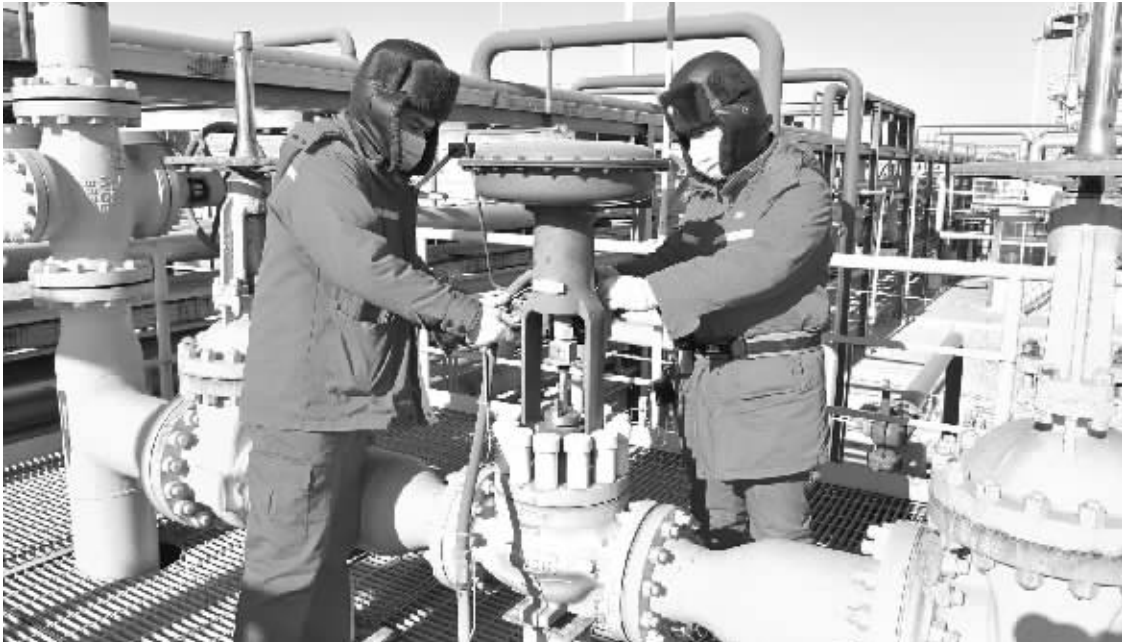
新年伊始,采油四厂(滩海)集输作业区加强生产现场隐患排查与治理,强化危险作业风险辨识管控,全面梳理操作流程,进一步明确安全职责,确保安全生产。图为员工正在排除生产现场设备隐患。(通讯员 张宇锋)
