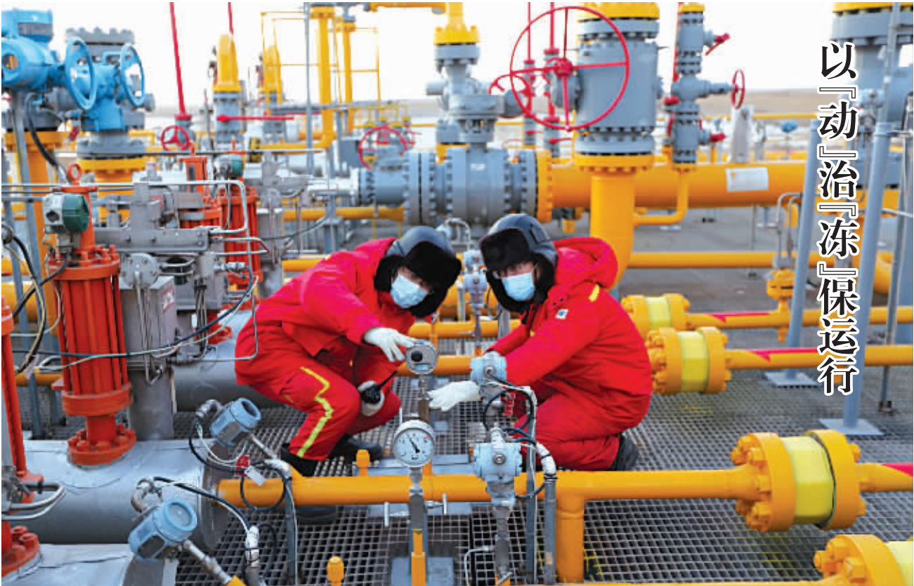
为确保采气工作顺利实施,大张坨储气库加密巡检,严查隐患,以“动”治“冻”,以实际行动保障储气库平稳运行。图为储气库工作人员对设备进行巡检。
