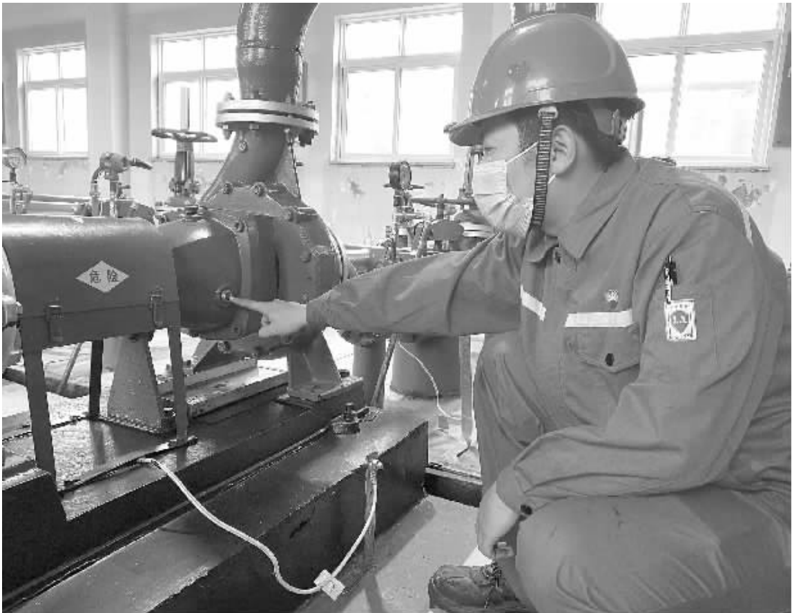
采油一厂抓细抓实基础管理，加强设备日常保养以及维护工作，不断提高设备运行效率，为保障冬季安全生产奠定良好基础。图为该厂员工正在对备用泵机油液位进行检查。（特约记者 刘淑瑞）
