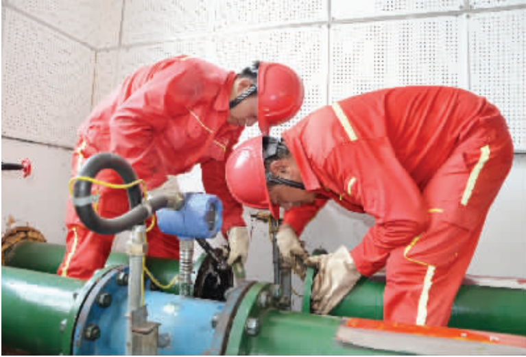
采油五厂输注作业区员工在泵房内更换流量计。
