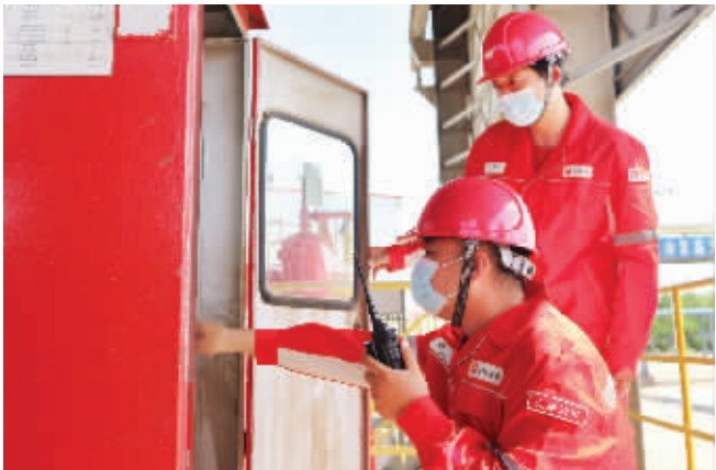
天然气处理站员工进行压缩机参数实时监控。(邱淑怡)
