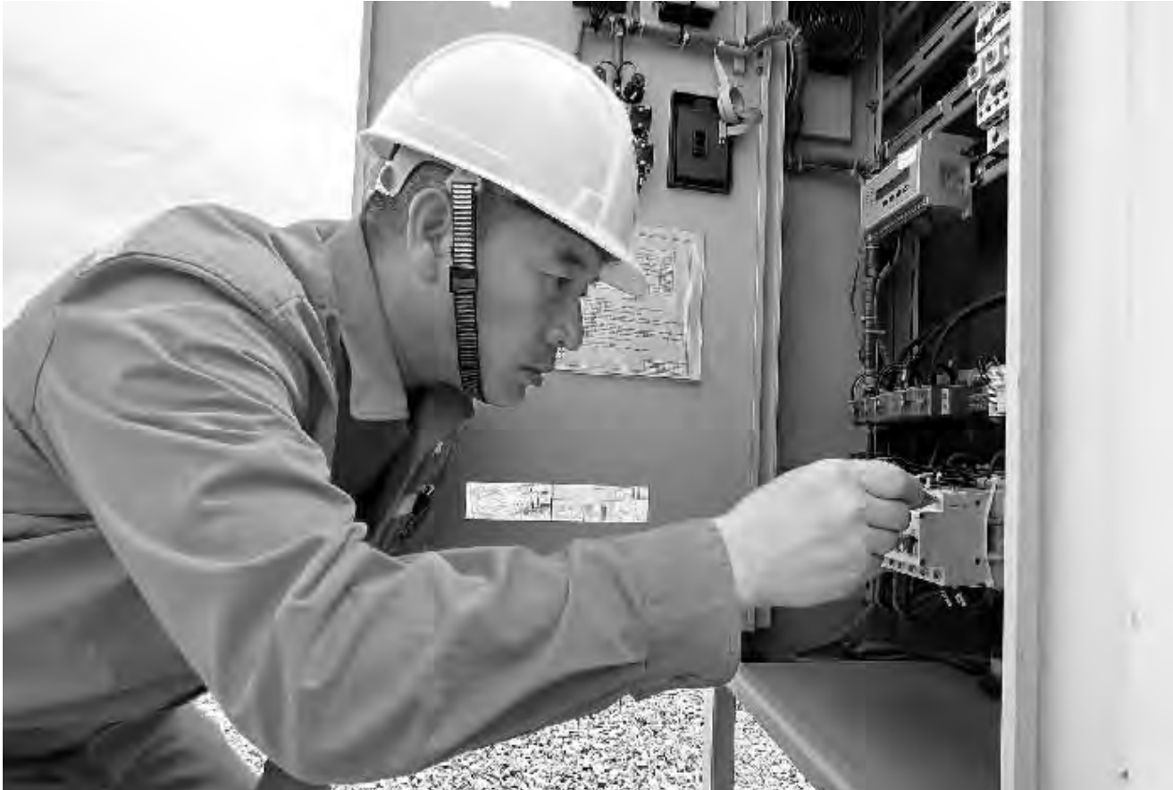
进入雨季生产, 采油一厂作业四区全面开展“事故隐患大扫除”活动, 以“强管理”为主线, 深入查找身边的薄弱环节, 及时进行整改, 为雨季安全生产保驾护航。图为作业区安全员正在检查配电箱。
