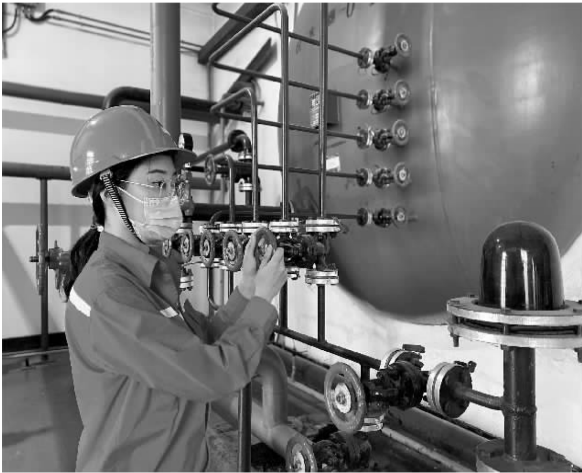
日前,采油四厂(淮海)板桥集输作业区自主完成配电箱的电线电缆连接工作,精准调节脱水压力,保障入罐原油质量,助力稳产上产。图为岗位员工正在观测油罐液位。(通讯员 闫泽润)
