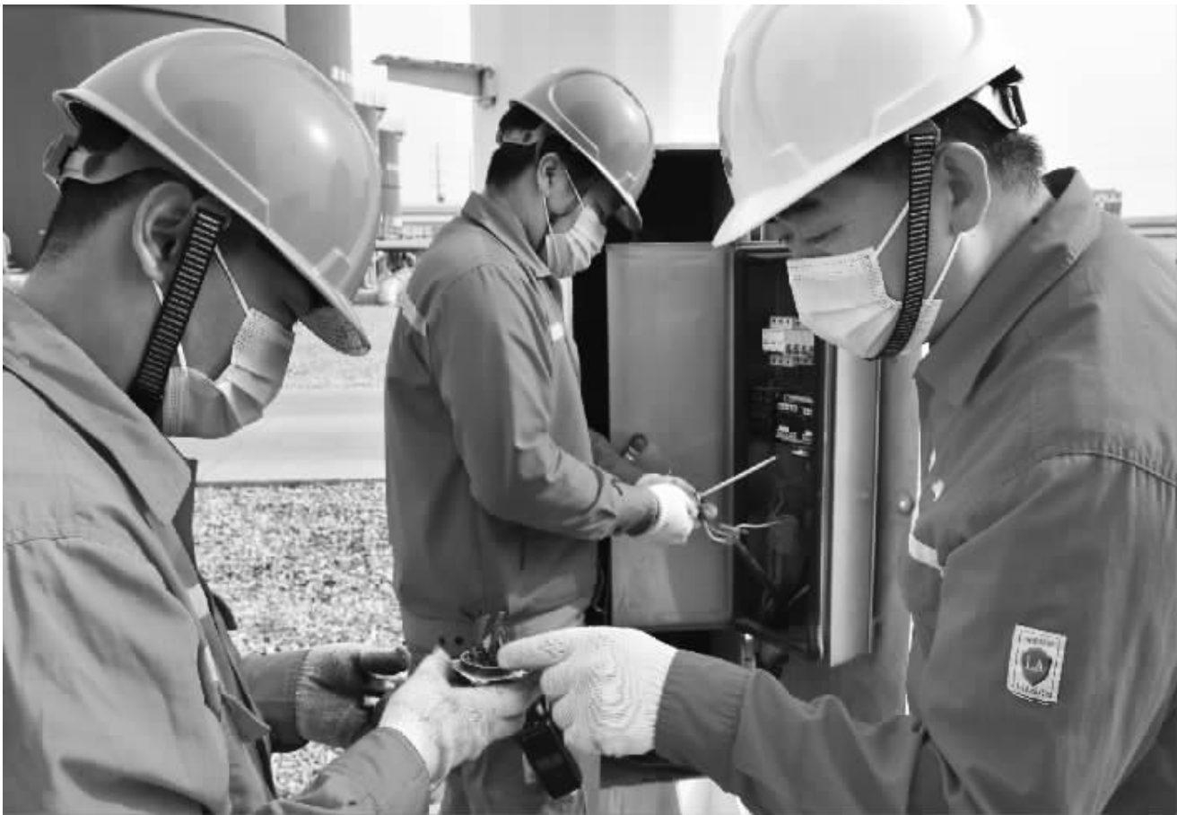
进入雨季生产,采油四厂(滩海开发公司)滩海集输作业区加强防汛应急演练,全面盘点防汛应急物资,深入排查整改各类隐患,为安全度汛奠定坚实基础。图为该区员工正在排除电气设备隐患。(通讯员 张宇峰)
