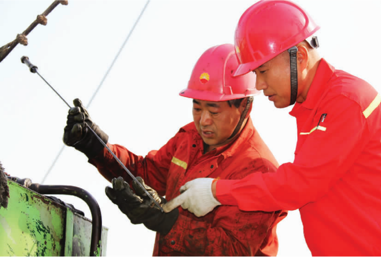
井下作业物资装备管理站大班司机在 402 队施工的西 1-12-2 井检查机车液压油。(张鹏)
