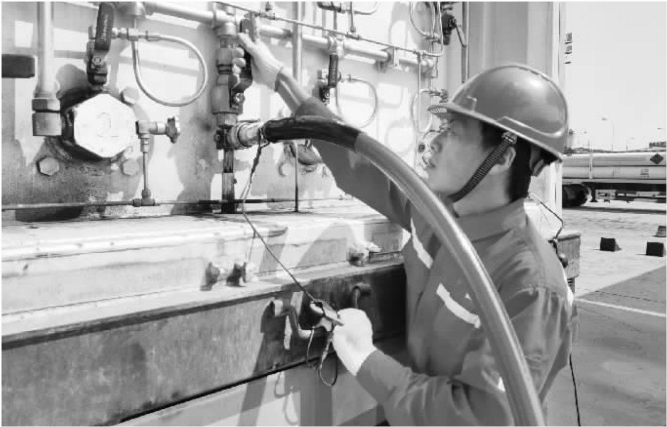
截至目前,天然气公司 CNG 管理站安全充装已达 18 年。该站员工始终坚守岗位,为大港油区和天津、河北等地绿色低碳发展、节能减排做出了突出贡献。图为运行班员工正在为长管拖车进行充装前的安全检查。(通讯员 周婷 杨硕)
