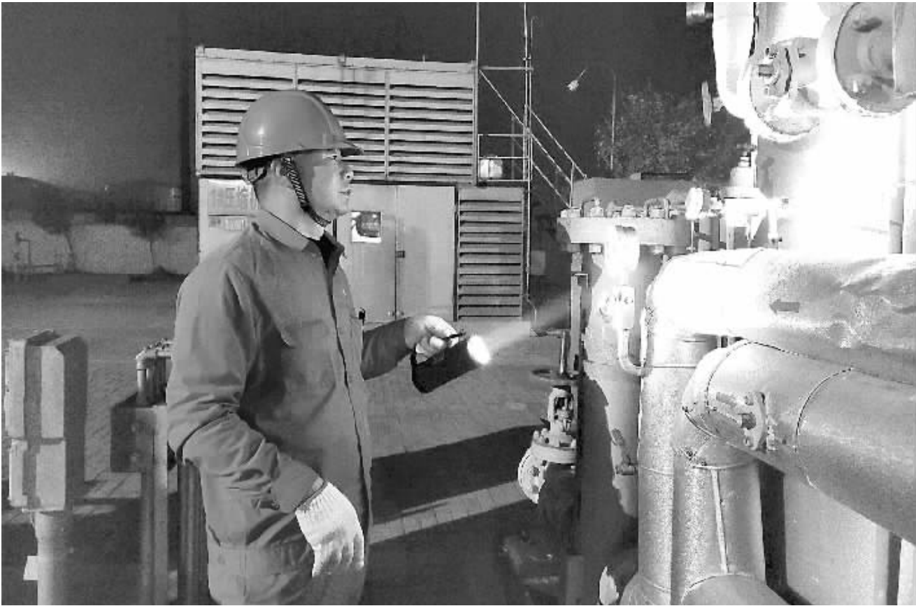
5 月份,正值“夺油上产百日会战”关键时期。天然气公司 CNG 管理站周密部署上产计划,紧盯设备运行状况,发扬“5+2”“白加黑”的精神,全力做好充装服务。图为运行班员工夜间检查设备。(通讯员 杨硕)
