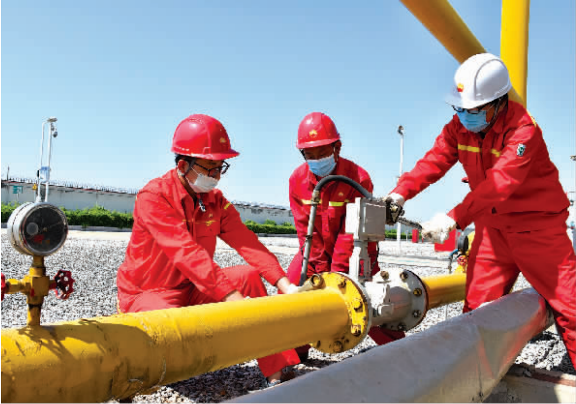
采油一厂输油作业区在百日会战中，全员参与，人人尽责，掀起上产热潮。截至5月10日，该区日外输原油7500立方米，日产气量保持在25万立方米高位运行。图为作业区干部员工正在对天然气管道流量计进行维护。（通讯员 王洪珍）
